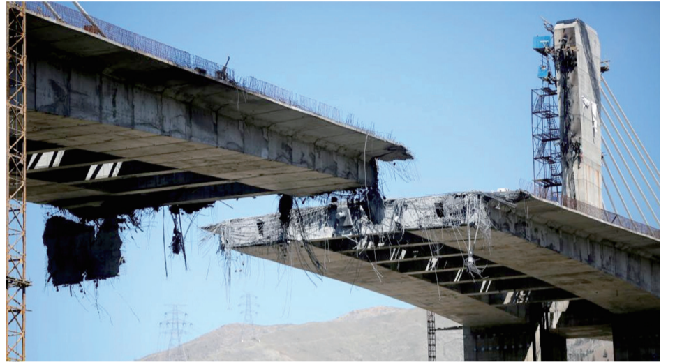
▲伊朗卡拉季市贝伊克公路桥遭空袭受损状况。
